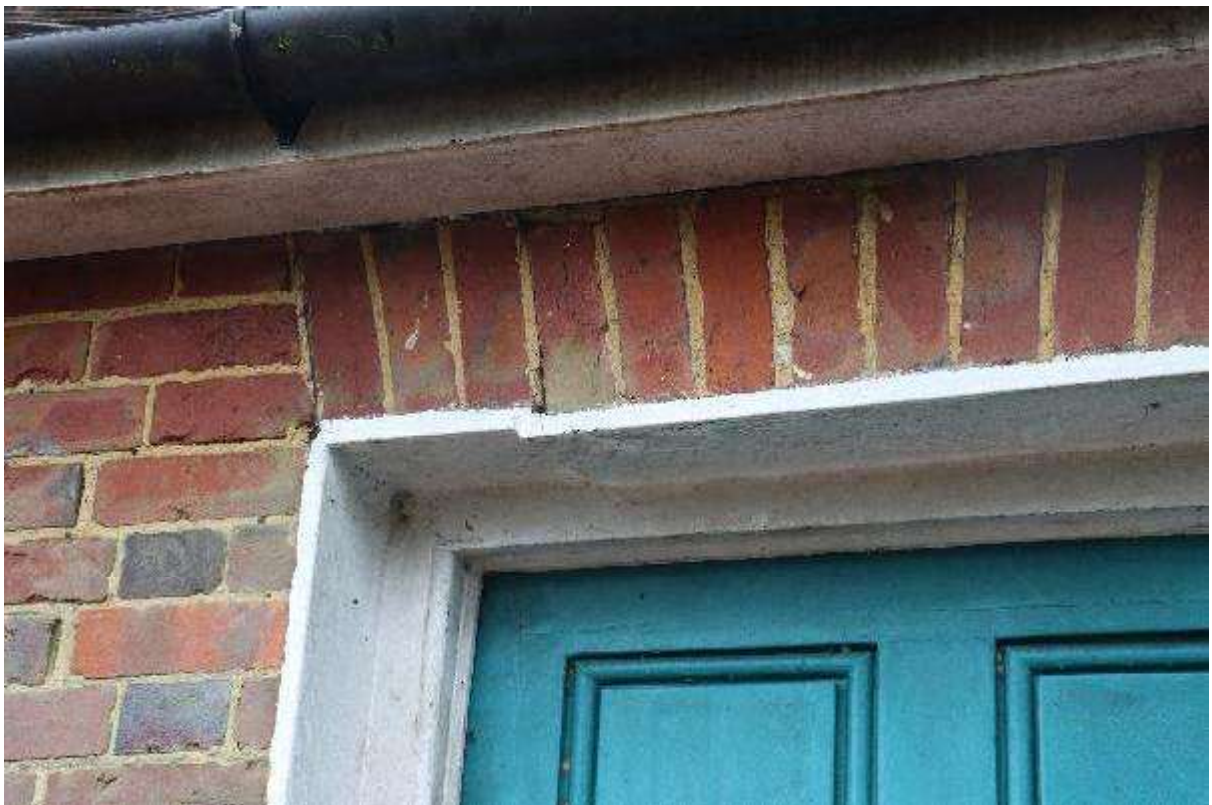
6. Side door lintel drop detail
