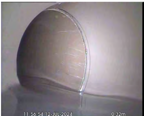
MH2X_e093e4d7-d568-40a8-a048-f18372491e2a_20240725_092700_602.jpg, 00:00:58, 0.32 m Line deviates left
