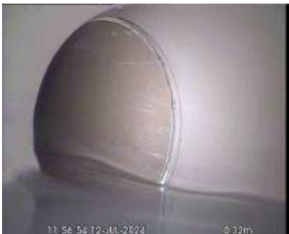
MH2X_e093e4d7-d568-40a8-a048-f18372491e2a_20240725_092700_602.jpg, 00:00:58, 0.32 m Line deviates left
